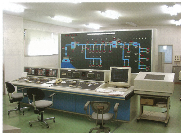
第2揚水機場水管理設備（小美玉市中延）
