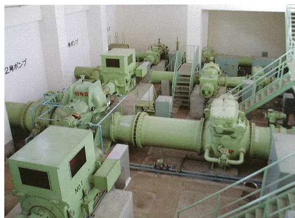
第2揚水機場ポンプ設備
