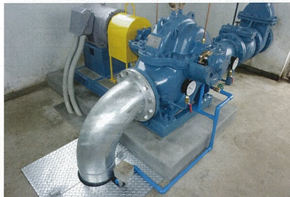
志筑地区 用水ポンプ更新
