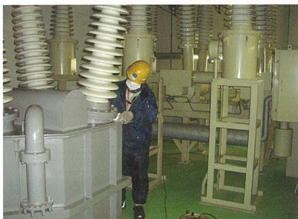
①特別高圧施設点検作業
