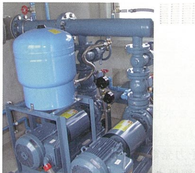
機場内に設置された用水ポンプ
