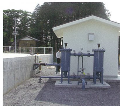
機場外に設置された濾過フィルター
