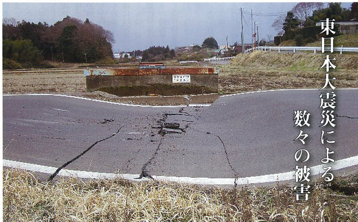
国営用水幹線の地盤沈下
