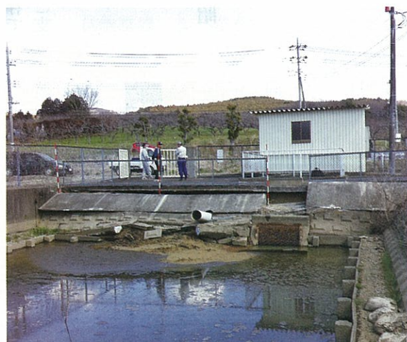
護岸が崩落したファームポンド
